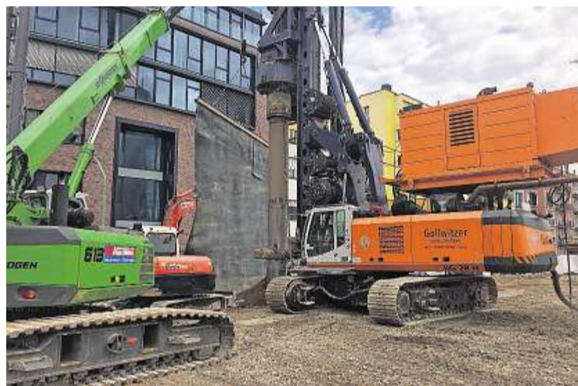
Die Firmengruppe Gollwitzer hat sich auf Spezialtiefbau, Baugruben, Kanalbau und Hochwasserschutz spezialisiert.
