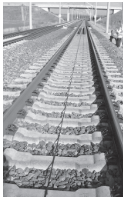
Abb. 2: Umgehung Stendal der HGV Hannover-Berlin: Schotteroberbau B 75 loarv 300 und Übergang zur Festen Fahrbahn; linkes Gleis mit 4 und rechtes Gleis mit 2 Beischiene
