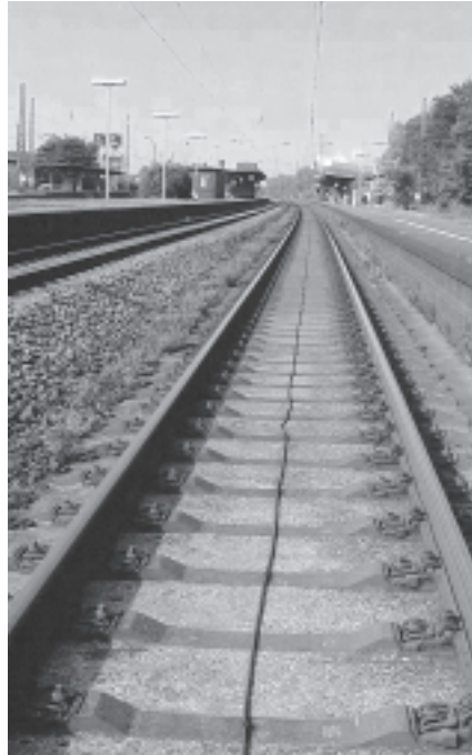
Abb. 3: Feste Fahrbahn zwischen Bielefeld und Hamm im Bahnhof Rheda im Jahr 1990; Baujahr 1972 (Quelle: Fa. Vossloh)
