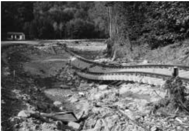
Straßen- und Schienenschäden im Müglitztal
