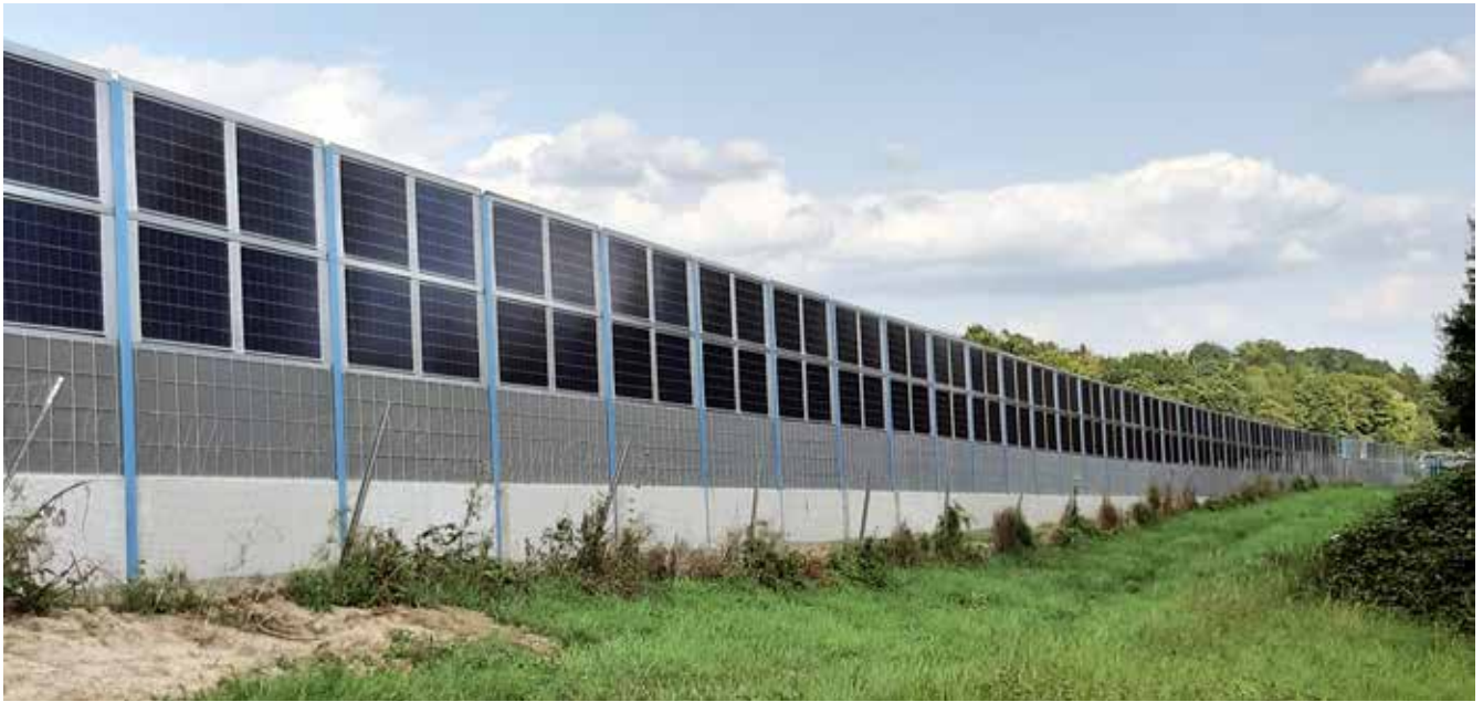
Fotovoltaikwand A3, Aschaffenburg
