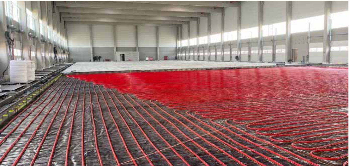
Industrieflaechenheizung DHL Logistikzentrum II, Aschheim
