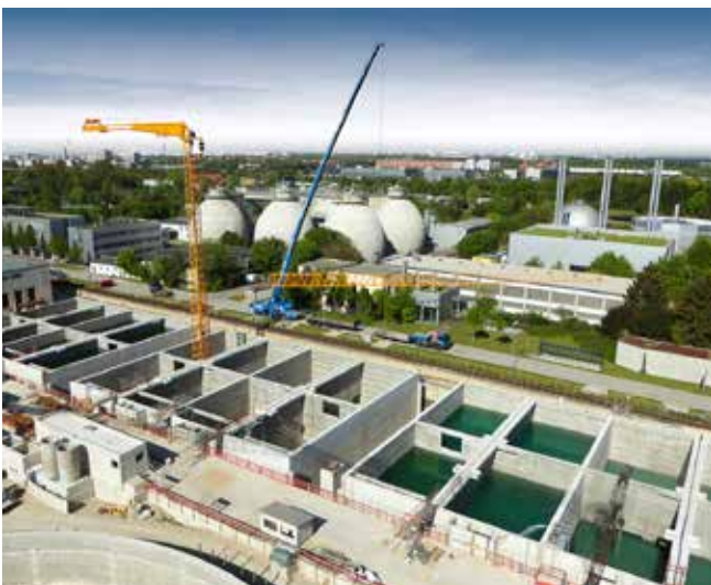
Kläranlage Gut Großlappen, München
