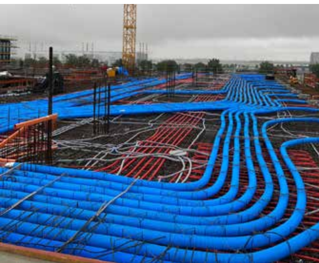
Betonkernaktivierung und Lüftung LabCampus Academy, München
