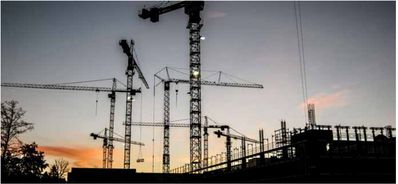
Produktionsgebäude und Parkhaus Heidenhain, Traunreut
