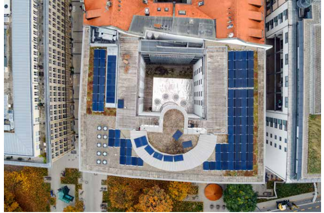
Photovoltaikanlage auf den Dächern der Hauptgeschäftsstelle der Bayerischen Bauindustrie
