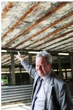
BBIV-Präsident Josef Geiger an der baufälligen Bahnbrücke Poccilindwurmstraße in München
