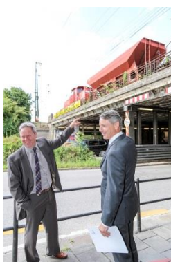
BBIV-Präsident Josef Geiger und BBIV-Hauptgeschäftsführer Thomas Schmid an der baufälligen Bahnbrücke Poccilindwurmstraße in München
